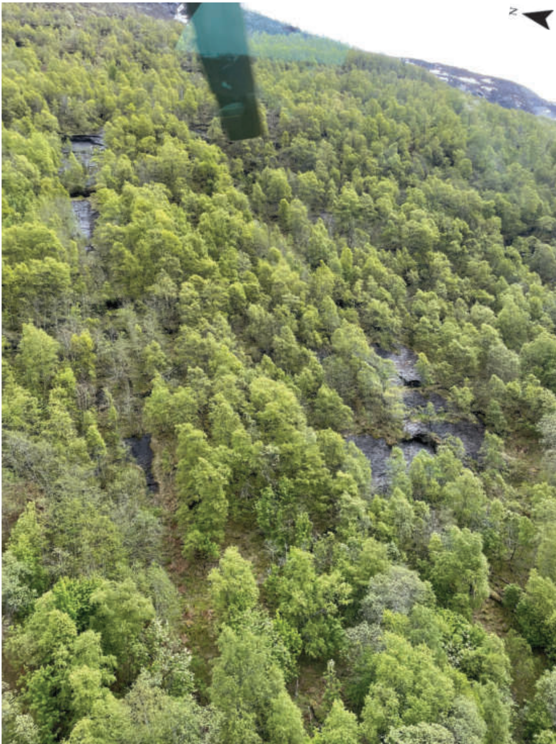
Figur 3-7. Fjellsiden i nedre del øst for dagens koplingsstasjon (her ca. 500-600 moh.) består av fyllitt. Berget har en skifrihet som gir tendens til å gli ut i flak slik som her er synlig fra tidligere utfall/sår.
