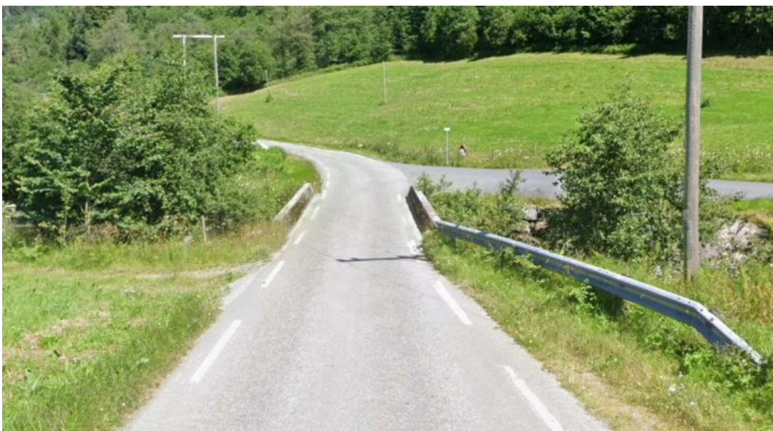
Figur 13 Eksisterende bru ved Ovrisdal er for smal og tåler ikke transformatortransport.
