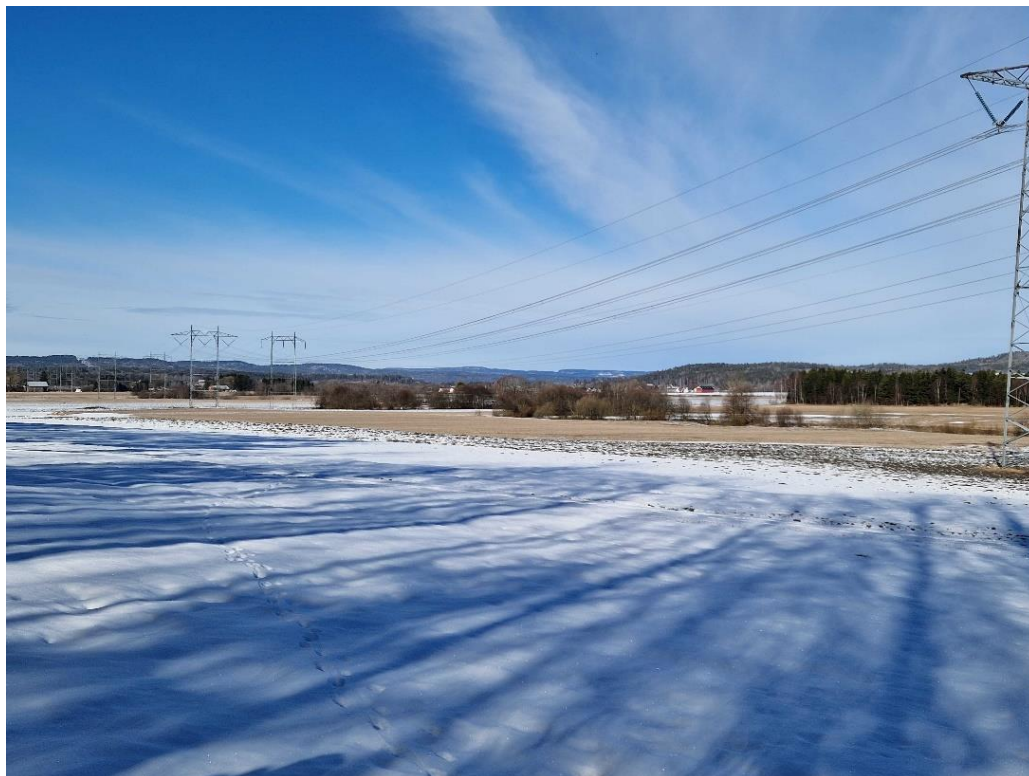
Figur 9 Eksisterende 300 kV og 420 kV mellom Tveiten og Rød. Bildet er tatt nord av Gulliåsen. Bilde: Sweco Norge AS.
