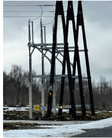
Figur 4: Bilde som viser eksempel på en 132 kV kabelendemast
