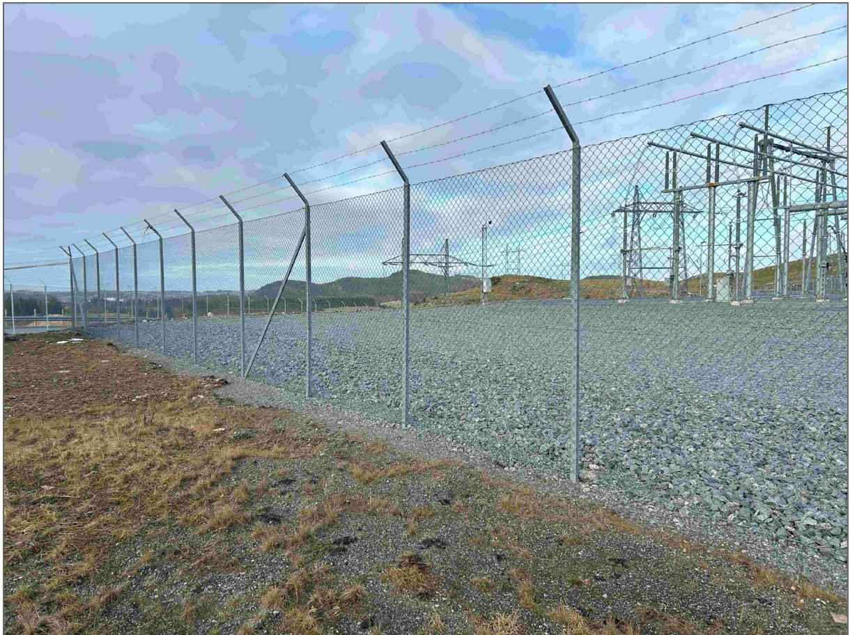
Figur 4 Fagrafjell transformatorstasjon er klargjort for utvidelse med ett nytt 300 kV felt.
